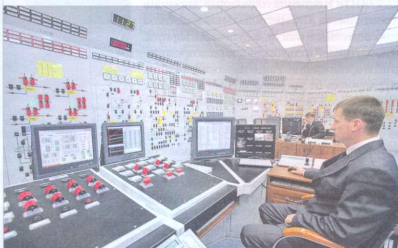
Блочный щит управления вторым энергоблоком Ростовской АЭС
